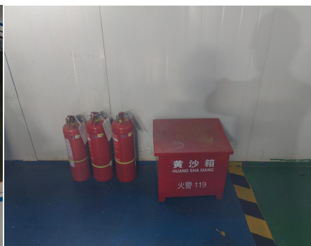
消防沙和灭火器
