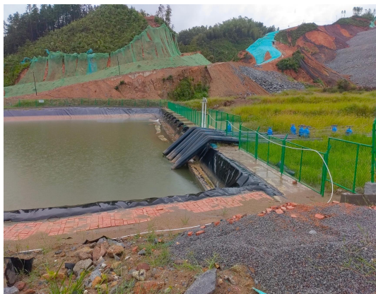
截渗坝和渗水回水池
