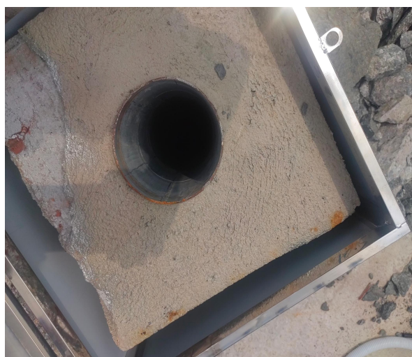
坝体浸润线观测孔
