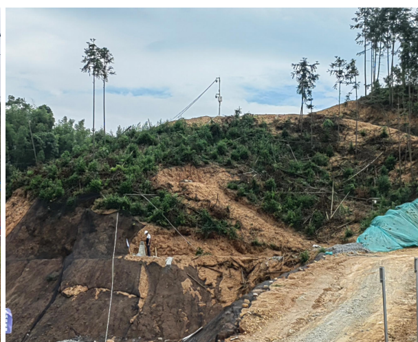
初期坝坝顶工作基点与视频监控仪
