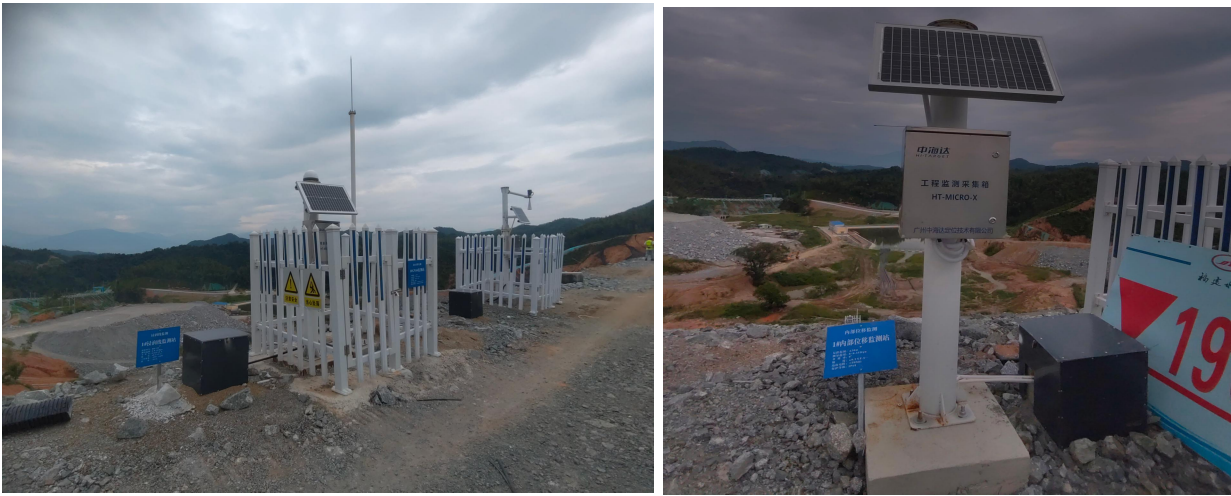
自左而右依次为在线浸润线、表面位移、内部位移监测仪
