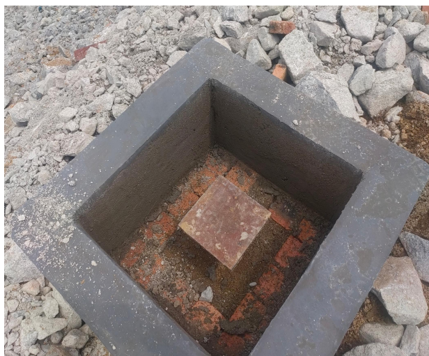
坝体位移沉降观测桩
