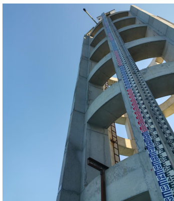
1#排水井库水位监控仪和库水位标尺
