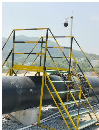
坝顶视频监控仪
